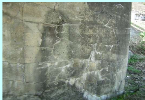
橋台のひび割れ
