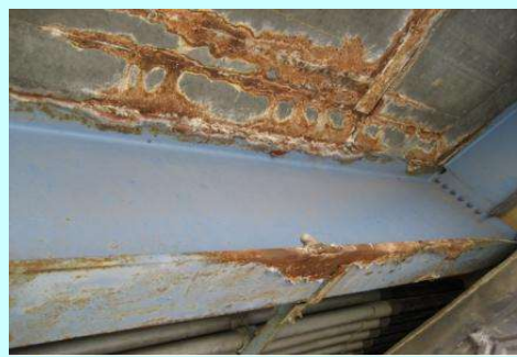
床版のひび割れから錆汁の発生
