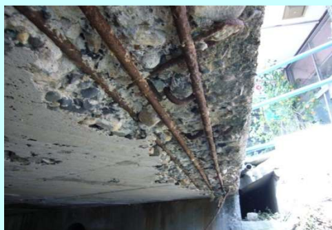
床版の鉄筋露出
