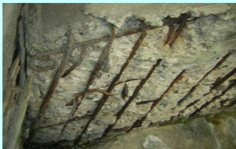
床版の鉄筋露出
