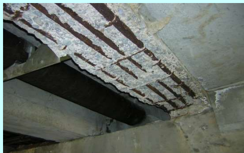
主桁の鉄筋露出
