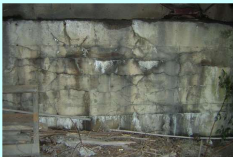
橋台のひび割れ
