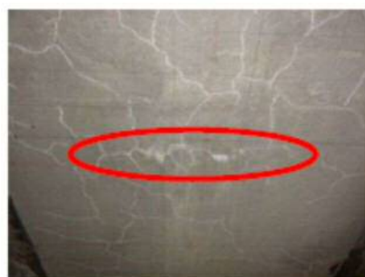
貫通ひびわれあり
