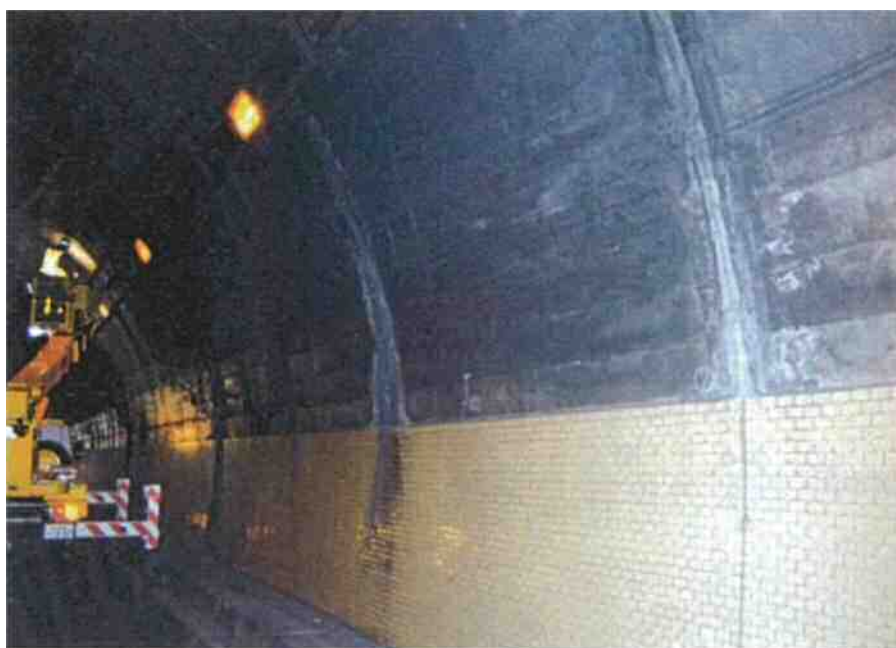
付写真 覆工スパンの中間付近に発生したひび割れの例
