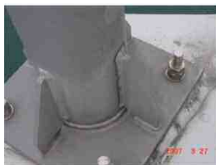
標識柱基部溶接部のき裂
