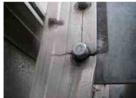
取付部の変状状況
