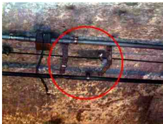
落下照明取付部の状況
