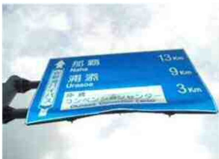
道路標識板の変状事例
