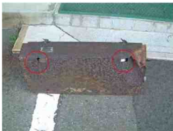
落下照明背面状況
