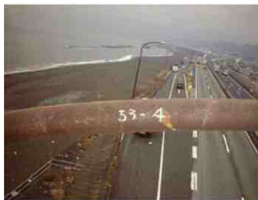
写真 8-11 支柱本体の腐食事例
