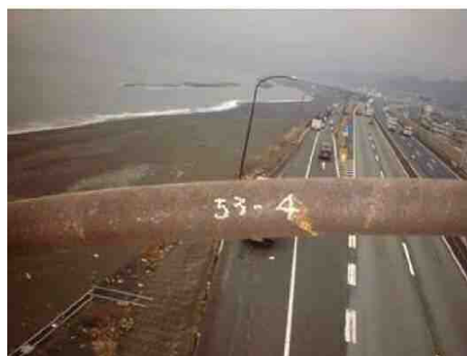
写真 8-7 支柱本体の腐食事例
