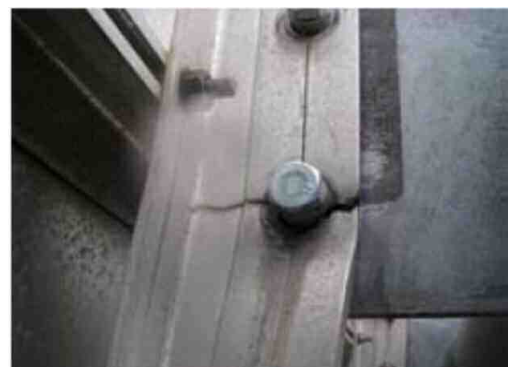
取付部の変状状況
