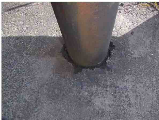
腐食、路面付近での滞水
