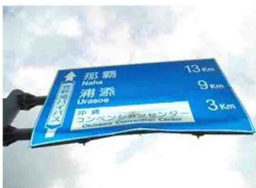
道路標識板の変状事例
