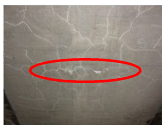
貫通ひびわれあり
