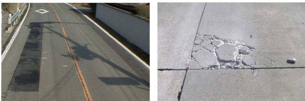
(占用復旧跡の沈下)
