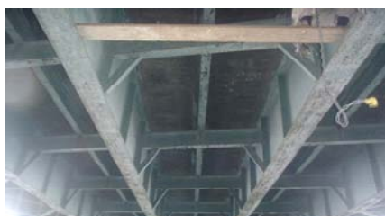
【床版の損傷状況】
