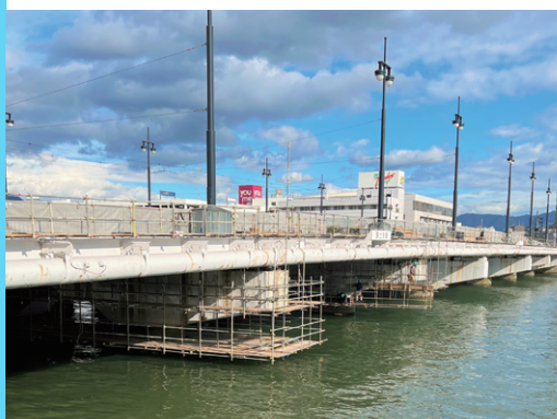
▲インフラ資産の老朽化対策 (御幸橋)
