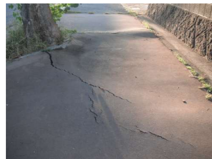
根上りにより舗装持ち上げが発生している
