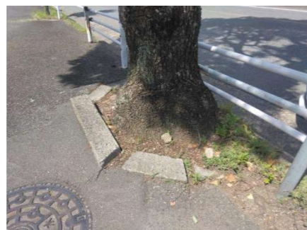
周辺構造物に破損が生じている
