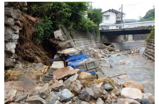
写真 5-17 大林町高谷川の被災護岸
