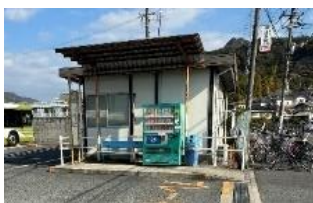
<老朽化した待合施設(郊外部)>
