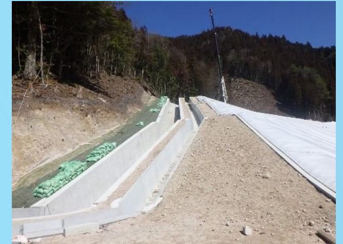
④ 北側バイパス水路
