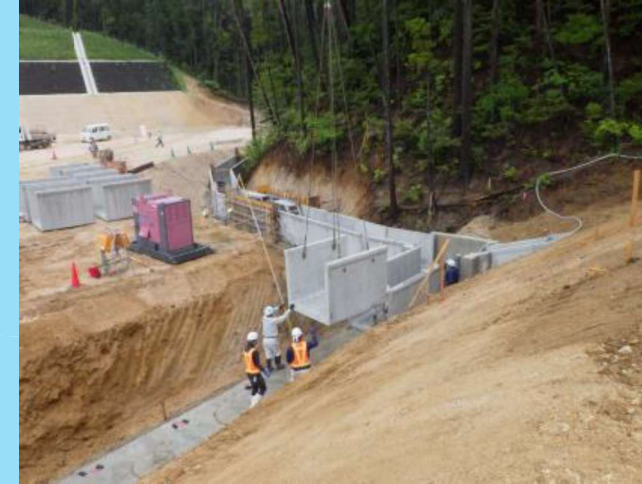
③南バイパス水路
