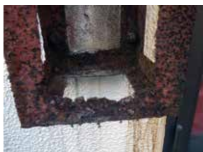
サビによる腐食で劣化が進み、危険な状態になっている
