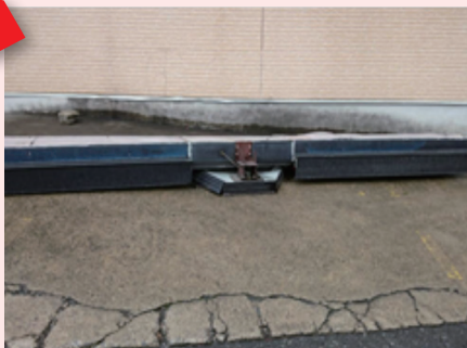
落下した欄間看板
