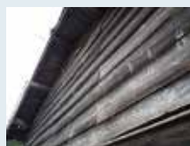
木素材のはがれ・劣化
