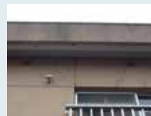
吹きつけ素材の汚れ・劣化
