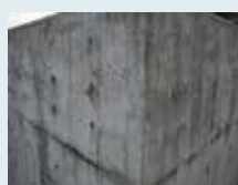
打放しコンクリートの劣化・汚れ
