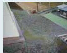
カラーベストの劣化・汚れ・コケ
