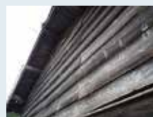
木素材のはがれ・劣化
