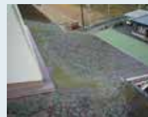
カラーベストの劣化・汚れ・コケ
