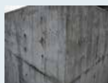
打放しコンクリートの劣化・汚れ
