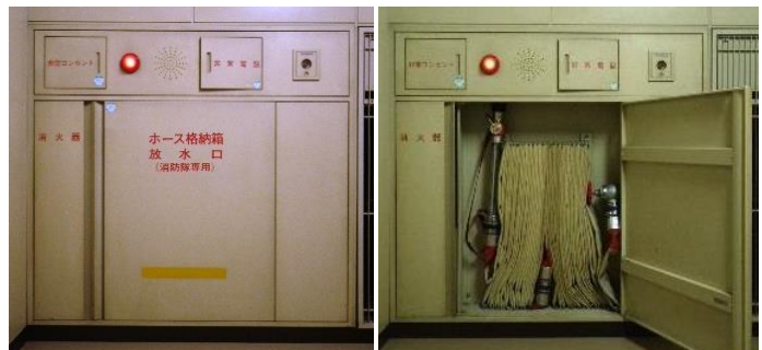
連結送水管の放水口
