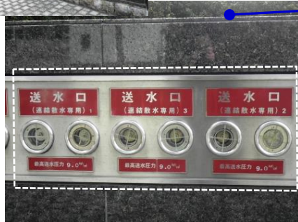
連結散水設備の送水口
