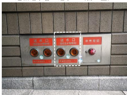
連結送水管の送水口（埋込型）
