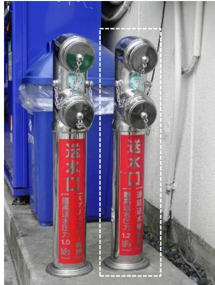
連結送水管の送水口（自立型）
