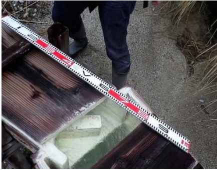
図 8 樋の中に設置されたレンガ
