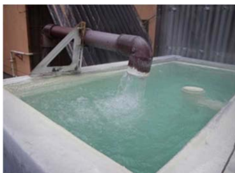
図 2 落下式ばっ気槽
