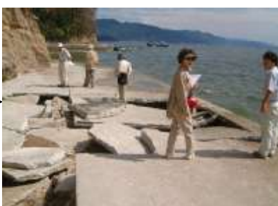
現地調査(海岸遊歩道：台風による爪跡)
