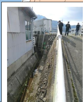
大雨時逆流する水路
