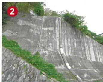
擁壁にひび割れ
