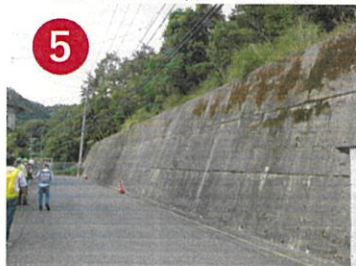
コンクリート壁の上部が急傾斜
