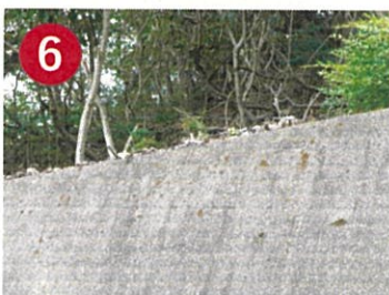
コンクリート壁上部の石が落下の恐れあり
