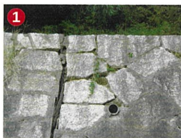
石垣の目地が脱落
