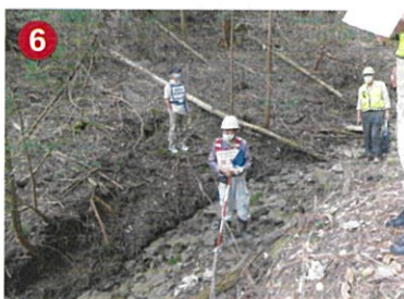
堰堤の上部 奥行300m 上下差100m土石流跡あり
