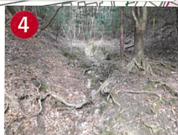
堰堤の上部 土石が流れた痕地すべりの痕がある
