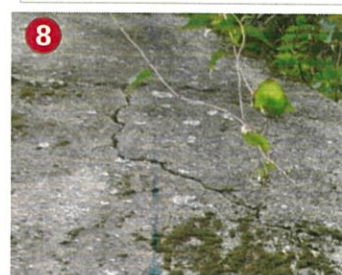
擁壁にひび割れ
