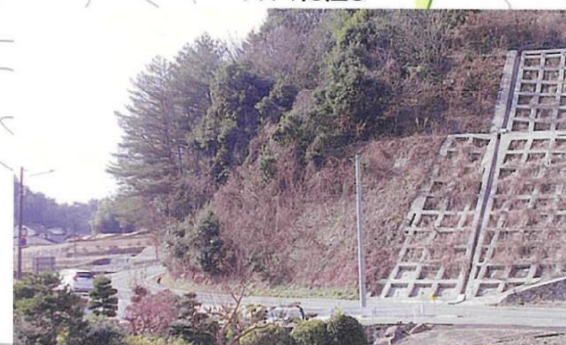
がけ崩れの発生 H11.6.29
