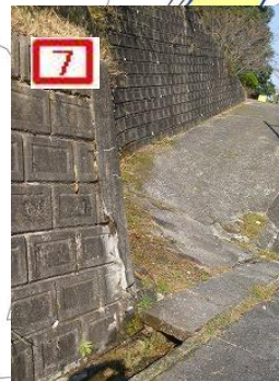
ブロックのクラック
