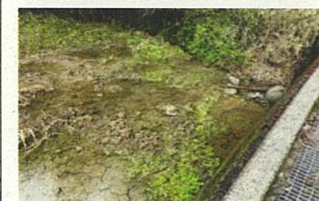
水路が埋まって冠水
