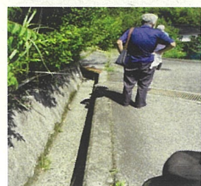
水路が狭くなり溢れて流水
