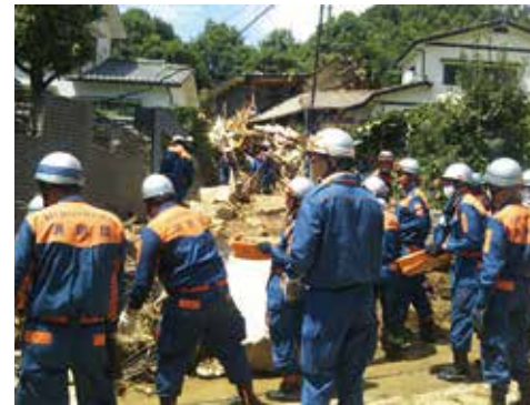
家屋倒壊現場で活動する消防団員（安芸区矢野東）
