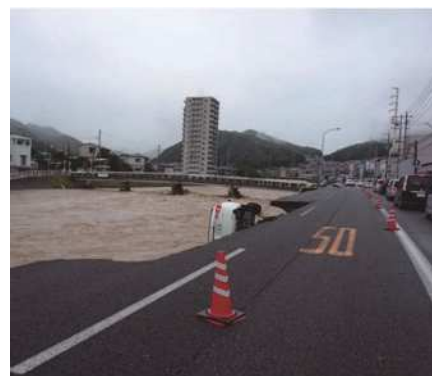
図-5 国道2号の道路流出
