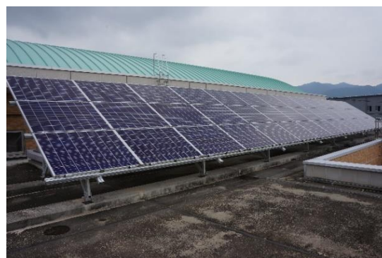
(太陽光発電施設)
