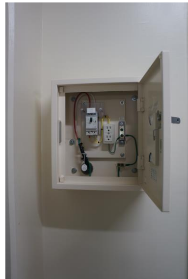
(非常用コンセント)
