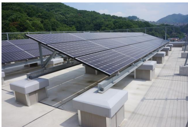
(太陽光発電施設)
