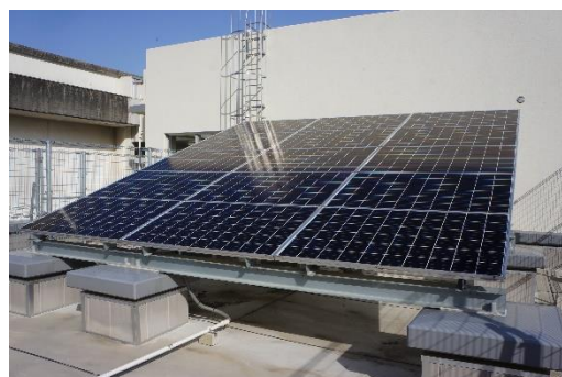
(太陽光発電施設)
