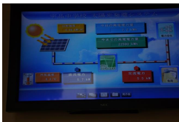
(モニター表示) 一階通路に設置
