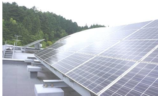
(太陽光発電施設)
