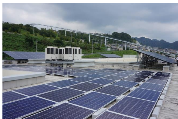
(屋根貸しにより設置されたパネル)
