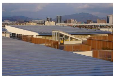
屋内運動場棟 屋根 95kW パネル(456枚)
