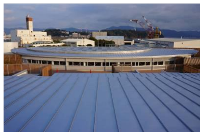
普通教室棟 トッポライト部 5kW シースルー太陽光発電設備
