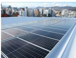
(太陽光パネル)
