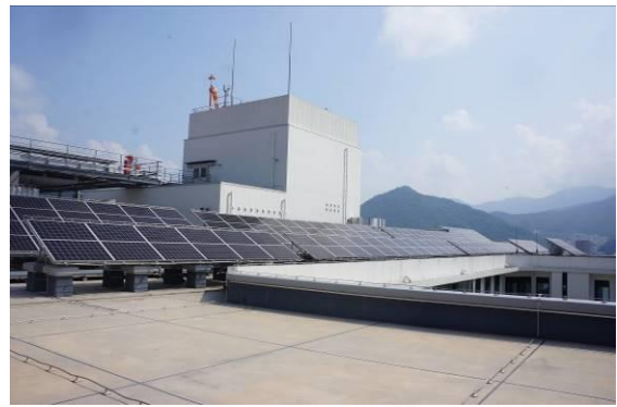
(太陽光発電設備)
