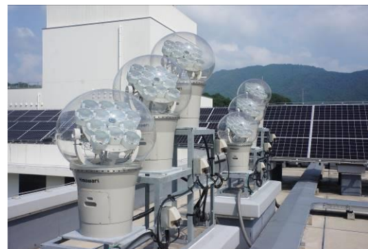
(太陽光採光設備「ひまわり」)
