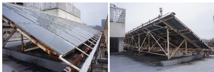
(太陽熱利用設備)
