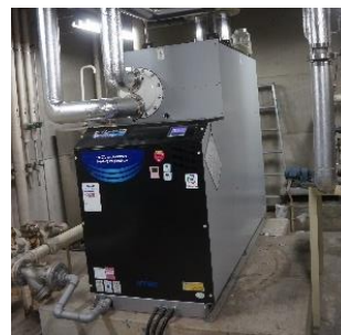
(加温のためのボイラ)
