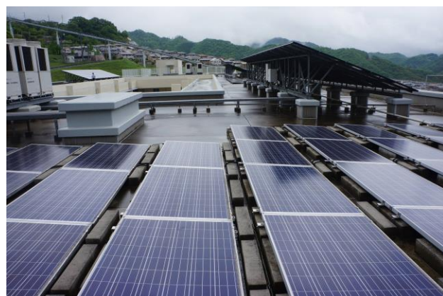
(太陽光発電施設)
