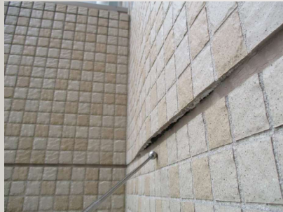
外壁タイルが浮いて膨らんだ状態
