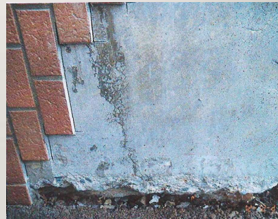
外壁タイルの一部が剥離落下した状態
