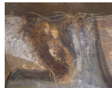
インバート破損 木の根侵入
