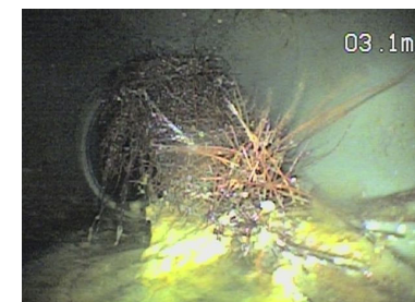
敷地排水管破損部より木の根侵入
