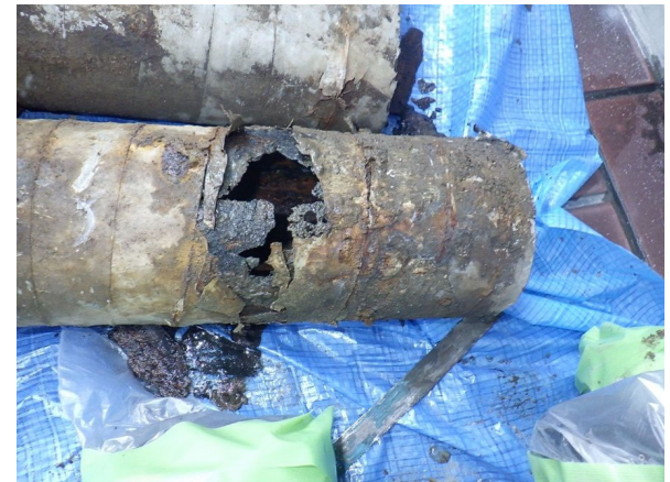
腐食により管底部分がほぼ消滅している
