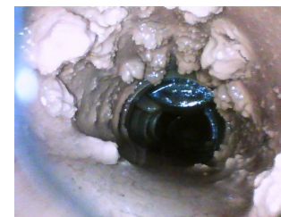
止水栓継手部
