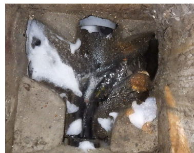
インバート破損 配管沈下
