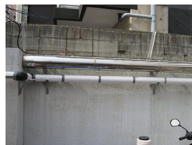
新規給水露出配管
