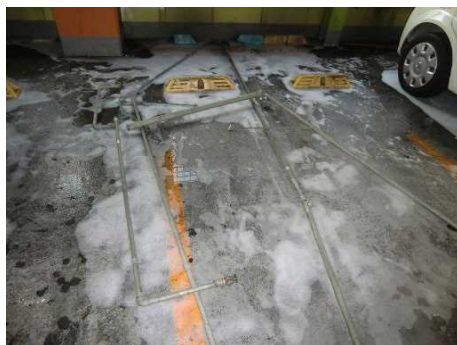
泡流出事故の例
