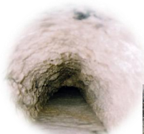
汚れた下水道管
