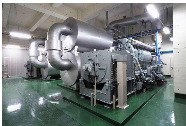
新千田ポンプ場（内部）
