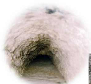
汚れた下水道管
