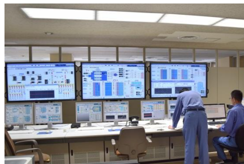
中央管理室での運転管理
