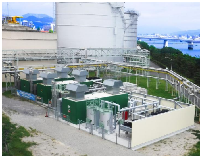
消化ガス発電設備
