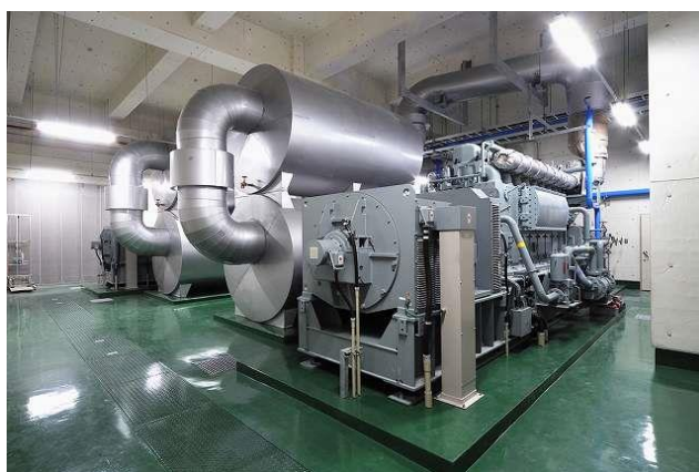
新千田ポンプ場（内部）
