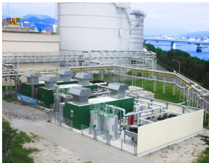
消化ガス発電設備
