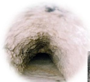
汚れた下水道管
