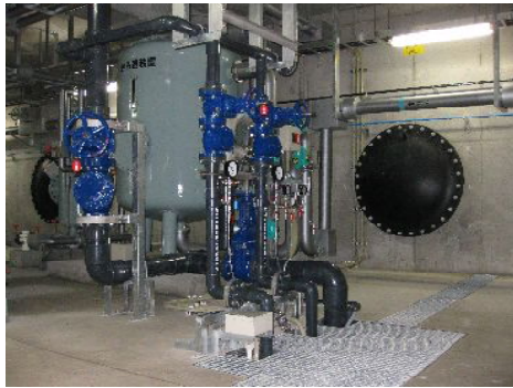
雨水再利用設備 (砂ろ過装置)
