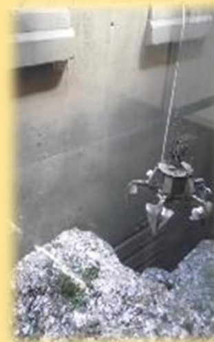
ごみクレーンとごみビット（中工場）
