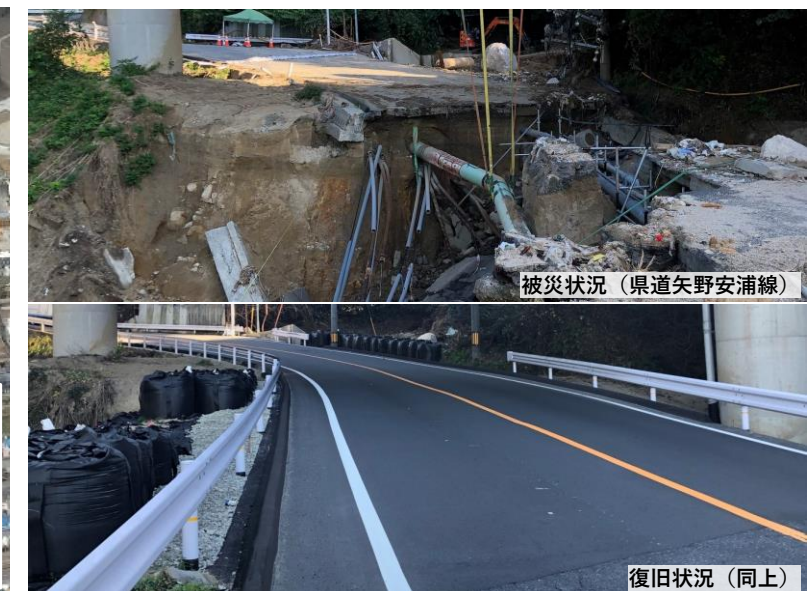
■ 平成30年7月豪雨災害の被災と応急復旧 ■
