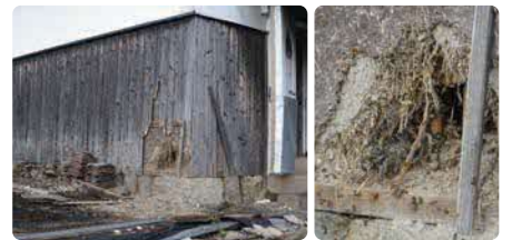
ハチの巣を狙って壊された建物
