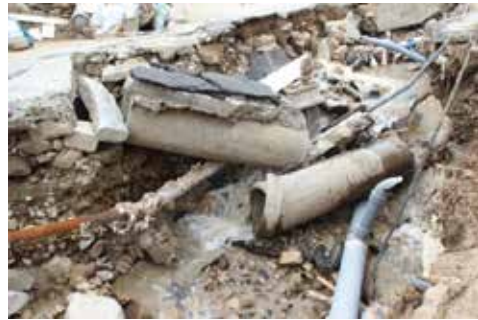
平成26年8月豪雨による 管路施設の流出
