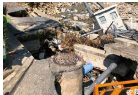
平成30年7月豪雨による マンホールポンプ制御盤の流出
