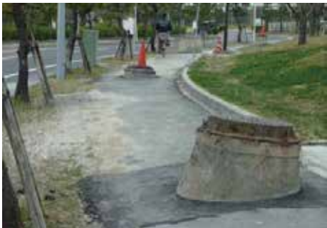
出典：国土交通省 地震によるマンホールの浮上
