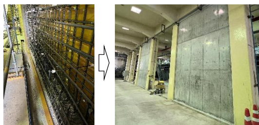
大州ポンプ場（令和5年度）
